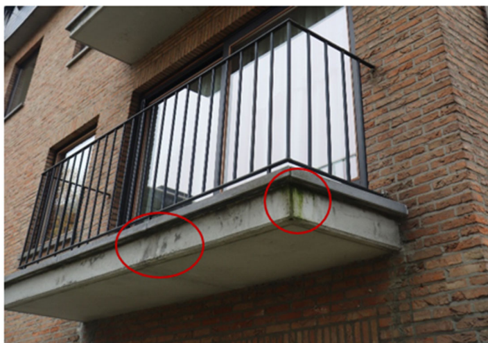
Figuur 10: Verkleuringen – mosgroei balkonrand
