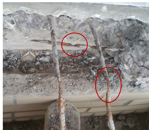
Figuur 27: Doorgeroeste wapening door putcorrosie - overgenomen van [2]
