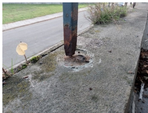
Figuur 29: Verankering balustrade doorgeroest
