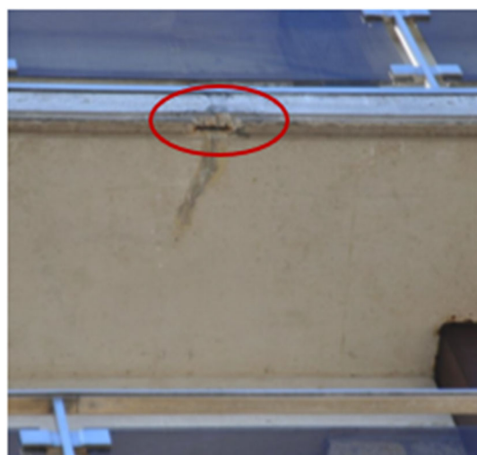
Figuur 23: Vrijliggende wapening
