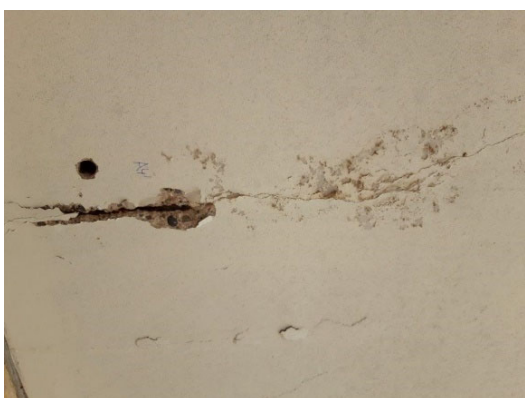
Figuur 24: Corroderende wapeningsstaaf onderzijde balkon
