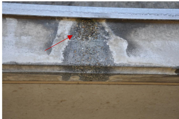
Figuur 12: Grindnest zichtbaar door erosie
