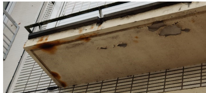
Figuur 26: Roestvlekken als gevolg van corrosie geïnitieerd door chloriden in kustomgeving
