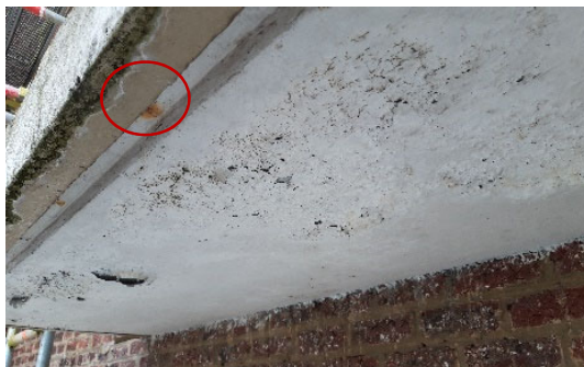
Figuur 21: Lokale roestvlekken onderzijde balkon
