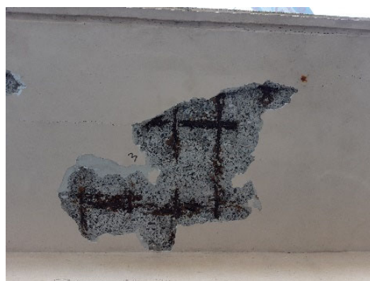
Figuur 25: Afdrukte betondekking als gevolg van corroderende wapening (combinatie carbonatatie en chloriden)
