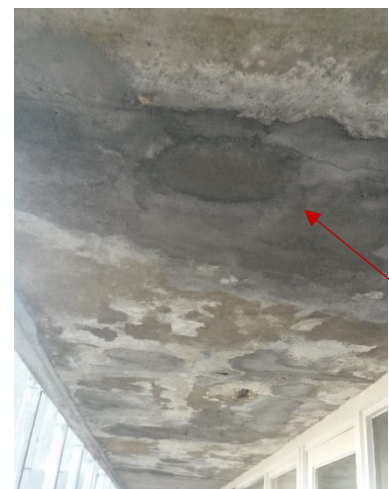
Figuur 31: Herstelschade onderzijde balkon
