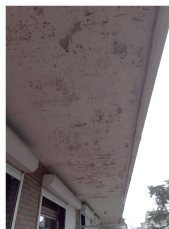
Figuur 9: Afbladderen coating
